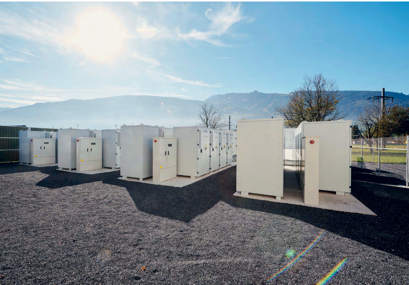
La flexibilité offerte par les BESS - Battery Energy Storage Systems intéresse Groupe E.
